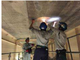
光ファイバセンサケーブル敷設の例
